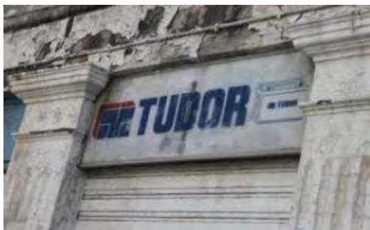
Enseigne en mauvais état d'entretien Rue Juliette Dodu
