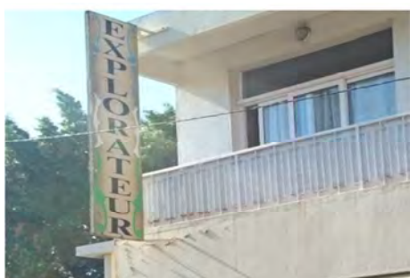
Enseigne drapeau non conforme au regard de la superficie maximale autorisée Rue Pasteur
